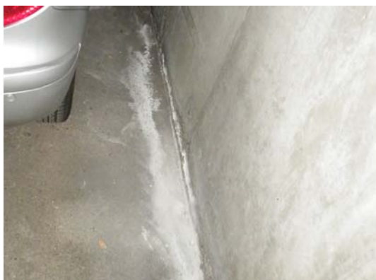
Abb.4: Salzränder, infolge einer Pfützenbildung an einem Wandsockel.
