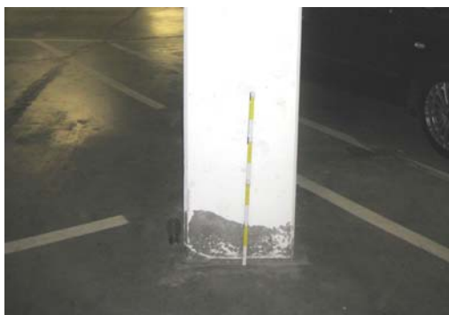
Abb.6: Abblätterungen des Anstrichs an einem Stützenfuß.
