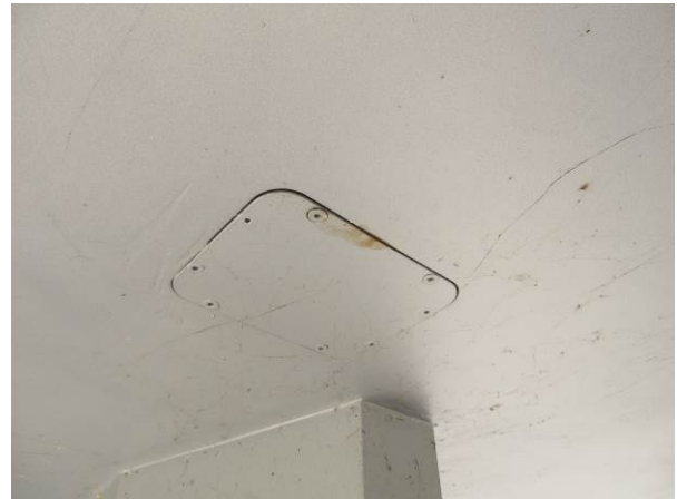
Bild 5: Rostaustritt infolge Undichtigkeiten aus einem als Hohlkasten ausgeführten Stahldach.
