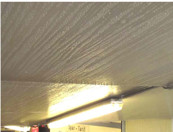
Bild 1: Starke Tauwasserbildung an der Decke einer Tiefgarage.
